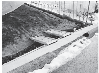
写真 2-21 機械出し入れラダー レール
